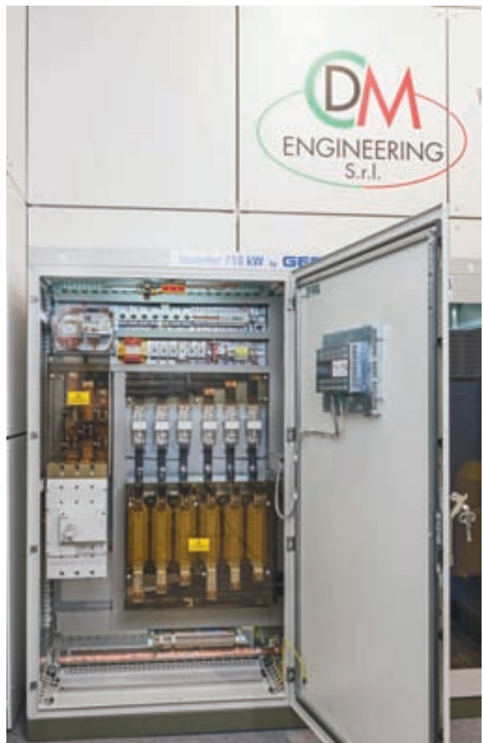
Il quadro elettrico dell'estrusore ES135C include interruttori per protezione motore PKZ0 collegati al PC industriale XP700 tramite il cavo SmartWire-DT
